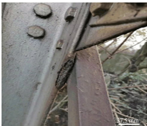
图 1 某服役 20 a 输电线路铁塔构件外观形貌
